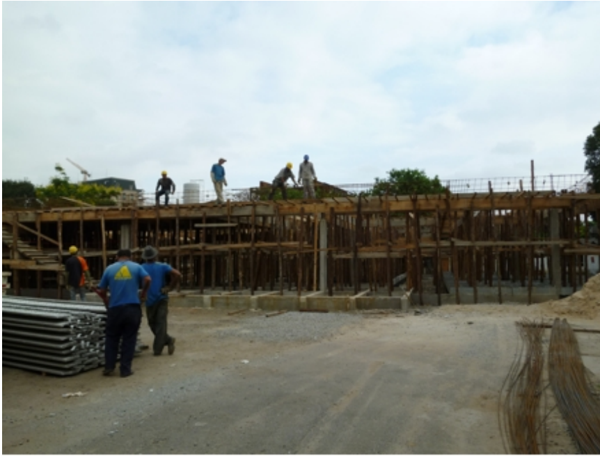
Retomadas as atividades no canteiro de obra do Núcleo de Bem-Estar. Foto: Regina Macedo
